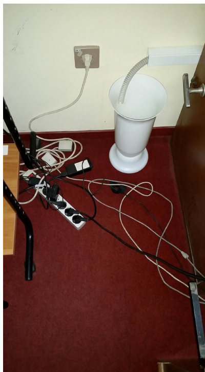
6. kép Nem megfelelően elhelyezett kábelek
